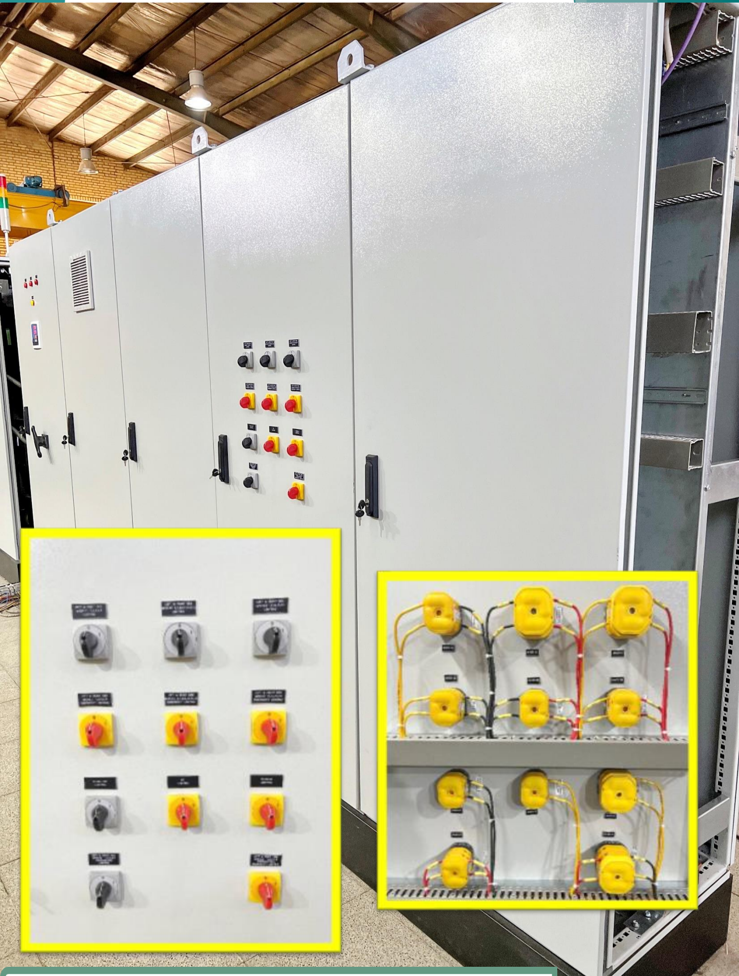
پروژه کابین رنگ زامیاد - شرکت سایپا. نمای خارجی تابلو برق و کنترل. شماره دو
