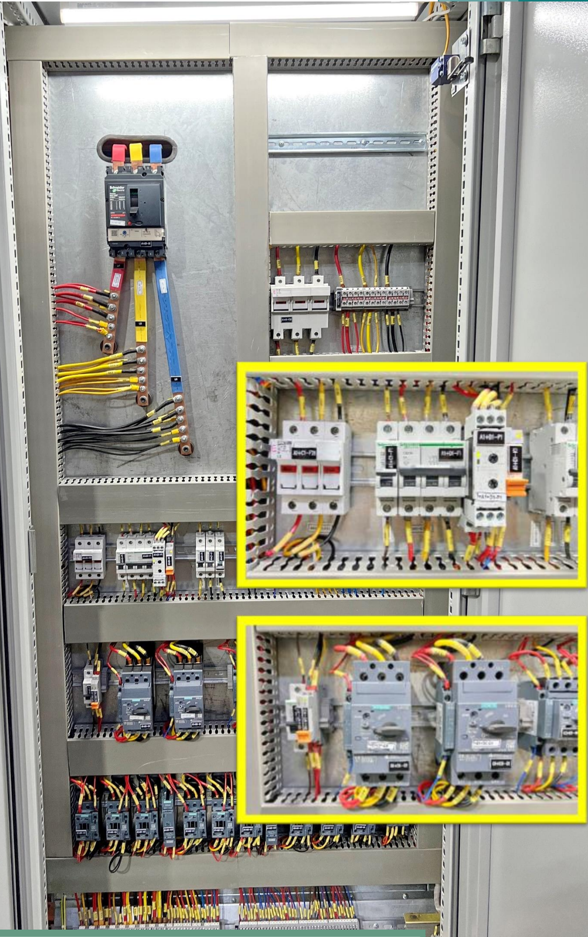
پروژه کابین رنگ زامیاد - شرکت سایپا. نمای داخلی تابلو برق و تجهیزات آن. ۵.
