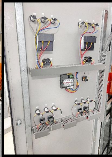
تابلو برق فیکس (Fix Panel)
