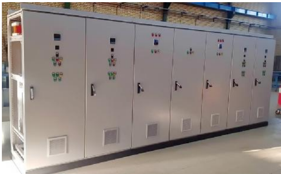
تصویر ۱- تابلو MCC نمای خارج تابلو - پروژه ایستگاه پمپاژ ایلام
