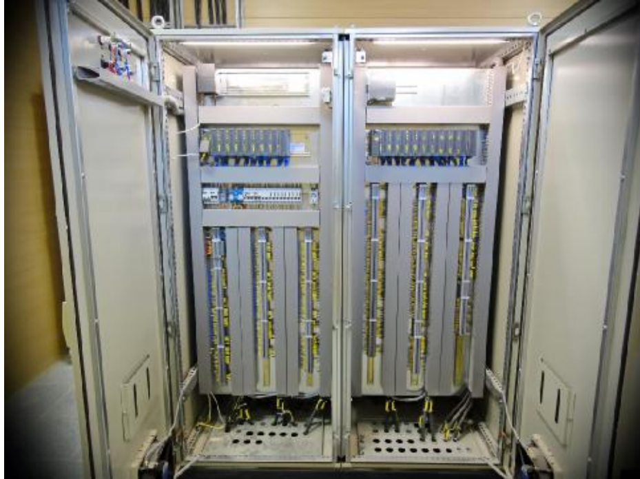
تصویر ۲- تابلو کنترل PLC- پروژه تله متری انتقال آب سد آزاد
