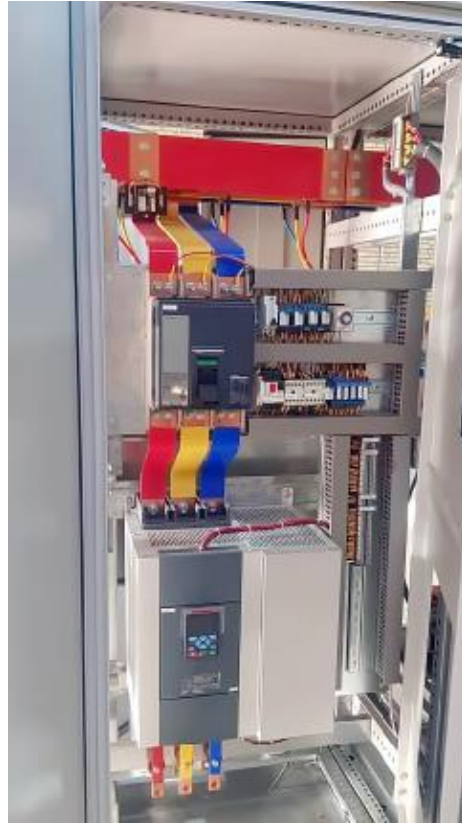
تصویر ۳- نمای داخل سلول تابلو MCC- پروژه ایستگاه پمپاژ ایلام
