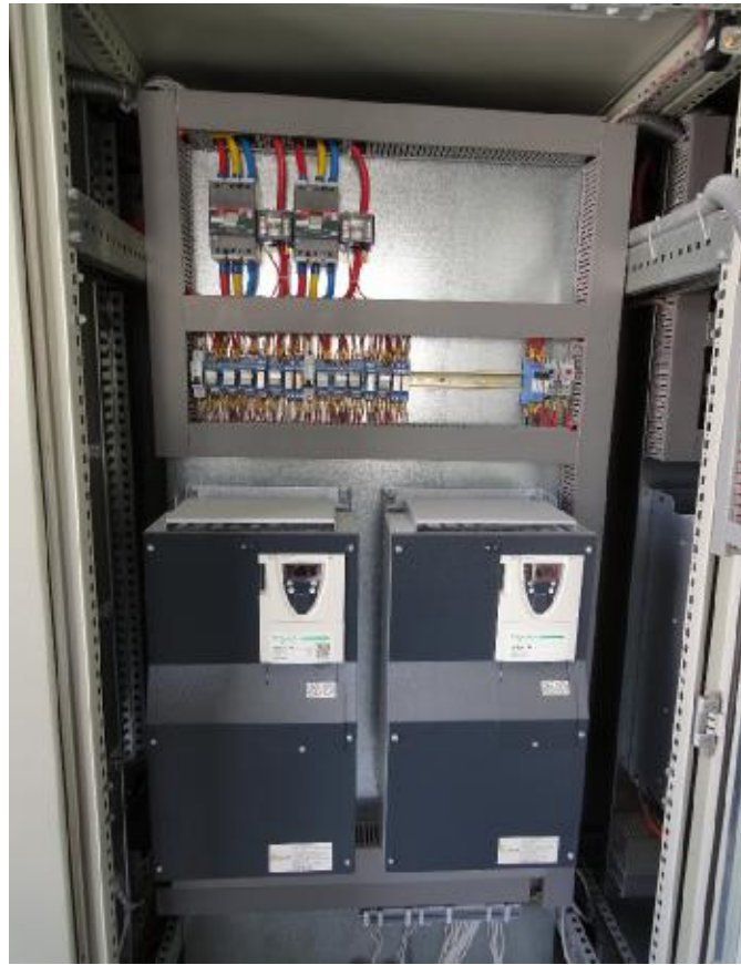
تصویر ۵- تابلو MCC بخش SBR- پروژه تصفیه خانه فاضلاب کیش
