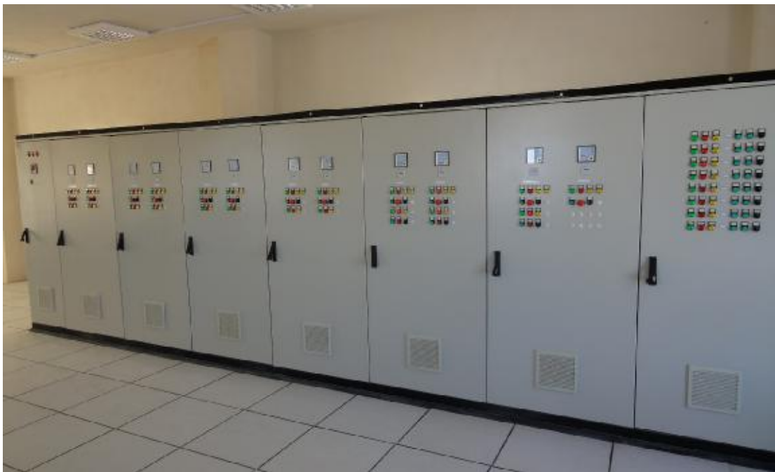
تصویر ۴- تابلو MCC بخش SBR- پروژه تصفیه خانه فاضلاب کیش
