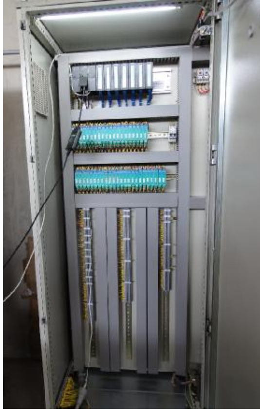
تصویر ۷- تابلو کنترل PLC- پروژه CF بندر امام خمینی
